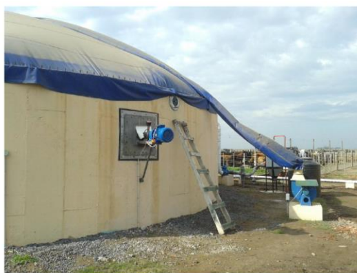
Figura 6. Vista de digestor con sistema de agitación y ventilador de aire para membranas – Fuente [8]
