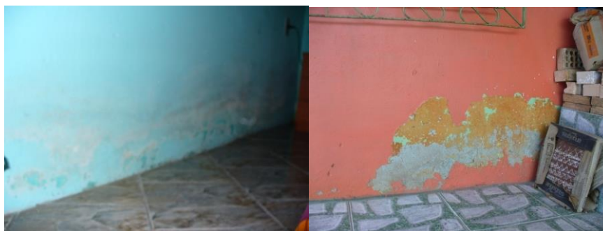
Figura 41: Humedad en las paredes por capilaridad
